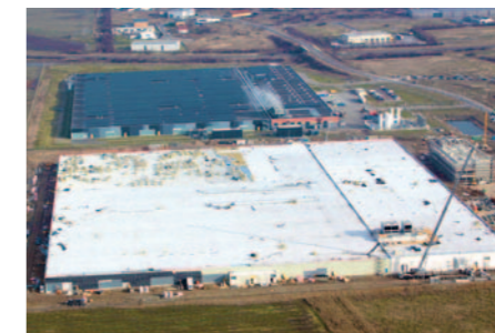
Aktuelle Luftaufnahme von der First Solar-Baustelle mit der neuen Fabrik im Vordergrund: Der Ausbau des Standortes Frankfurt (Oder) ist Teil der weltweiten Strategie von First Solar, die Produktionskapazität bis 2012 auf mehr als 2,7 GW auszubauen.
